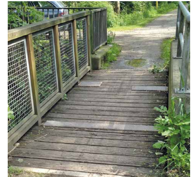
Unfallgefahr durch provisorisch ausgebesserte Holzbohlen
